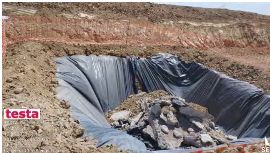
Pozo lavado sin corregir.
