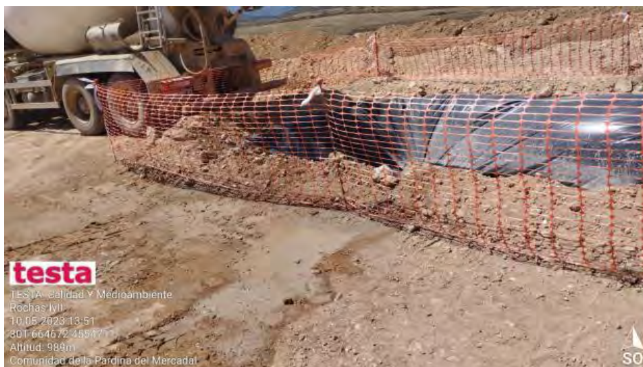
Agua de lavado de cubas por fuerte viento.
