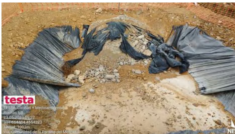
Pozo de lavado en mal estado.
